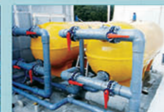
ライフサポートシステム 水処理濾過設備など、水槽内の動物に良好な環境を保つ為のシステムを、設計から施工まで行います。
